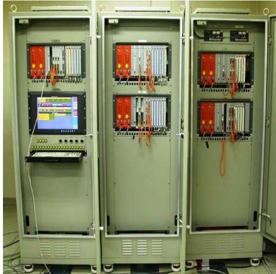
PLCs in cabinets (RPS)
